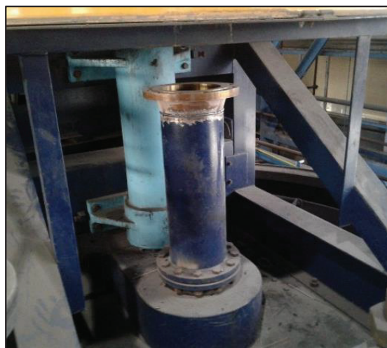
شکل ۳: لوله ورودی هوا در بالای سلول فلوتاسیون
